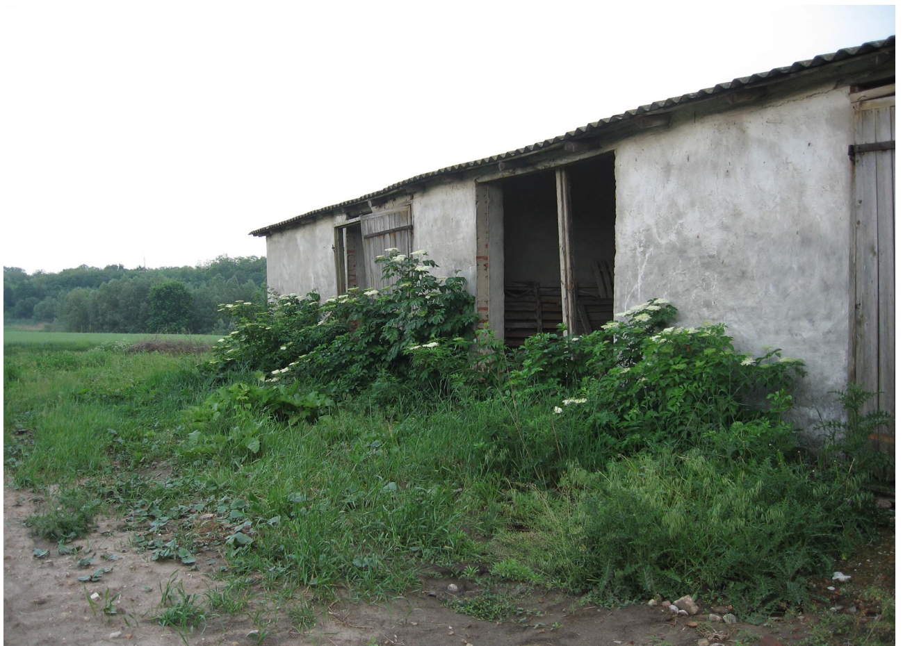
Рис. Загальний вигляд складу непридатних пестицидів
