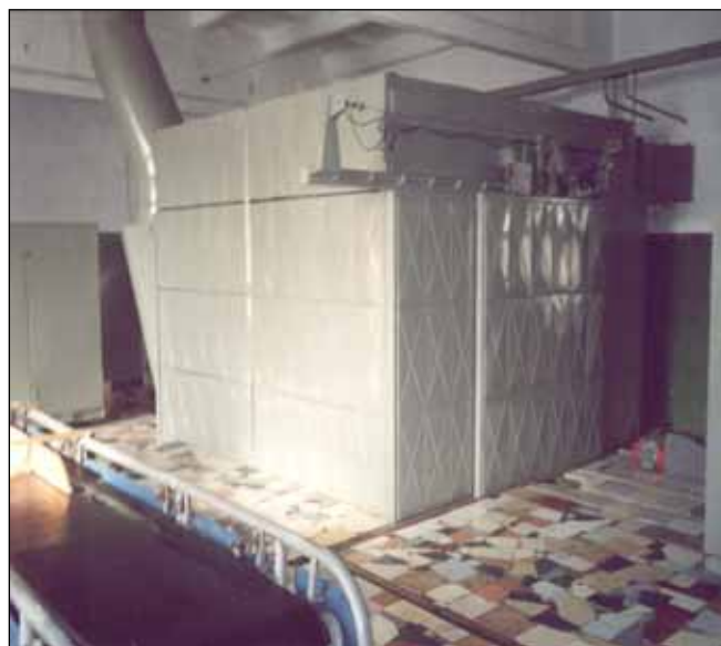
Рис. 3. Сушильна установка СУМ – 2
